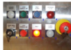
7.1.2 QUADRO DI COMANDO
