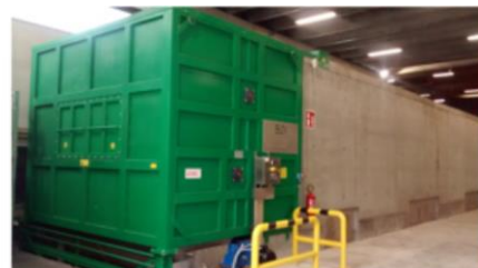
2.2.3.1 Bunker di alimentazione
