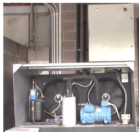
Figura 3 Vista generale - Gruppo esterno di raffreddamento
