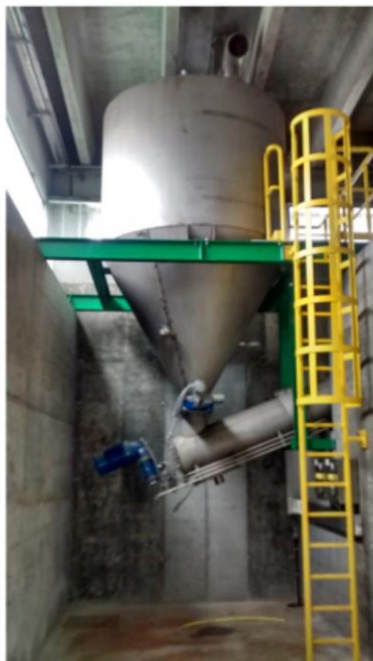
Figura 17 Serbatoio per digestato SD-10
