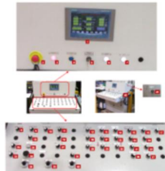
Figura 16 - Pannello generale di Comando
